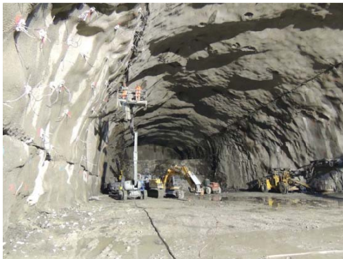
Excavation de la caverne principale des machines de la nouvelle centrale de Veytaux
